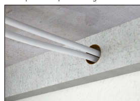
Tubos passando por uma viga
